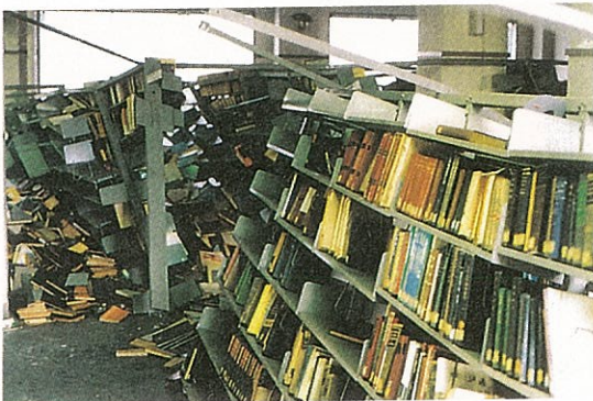
損壊したスチール書架 上部連結と床固定をしていたスチール書架が、ねじれるように損壊した。
